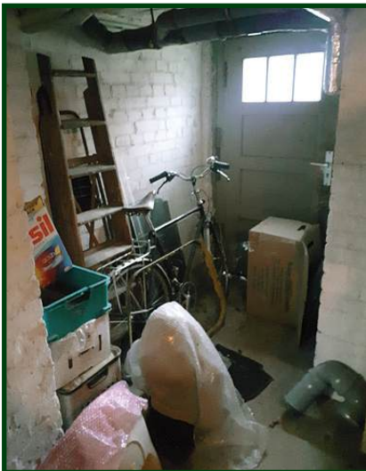
Ein zugestellter Kellergang der zur Falle werden kann. Fluchtwege sind ständig frei zu halten!
